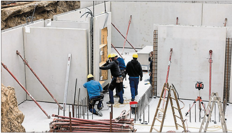
Schwierige Rahmenbedingungen führen zu hohen Baukosten und schlimmstenfalls zu Baustopps.
